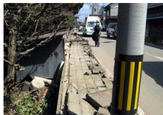
ブロック塀倒壊
