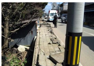
ブロック塀倒壊
