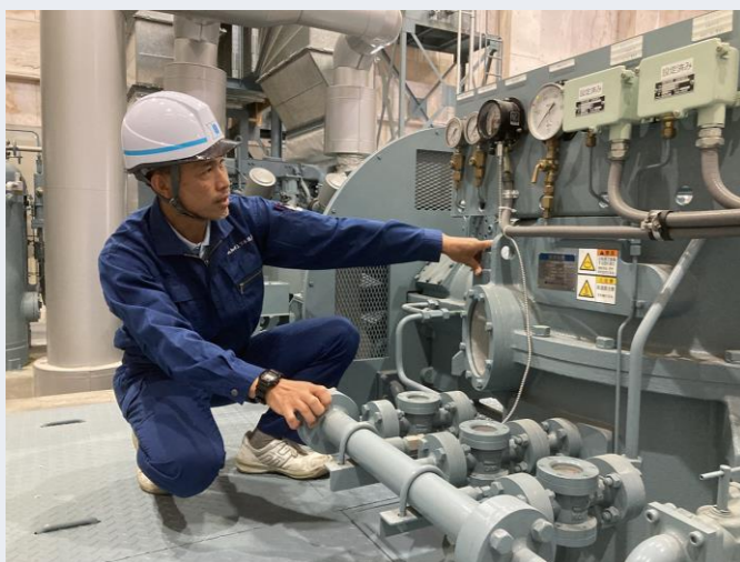
下水道施設管理課 雨水ポンプ施設エンジンの点検
