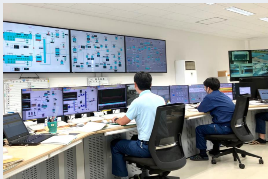
浄水課 針木浄水場中央コントロール室での運転制御
