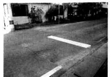
抜本的な改修すべき道路
