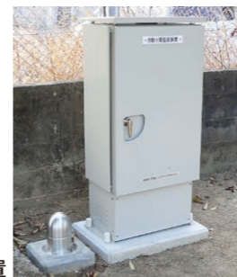
自動水質監視装置
