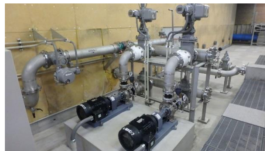
南部送水所インラインポンプ（高効率機器）
