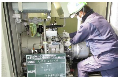
大津雨水ポンプ場 No.3ガスタービン エンジン長寿命化 工事
