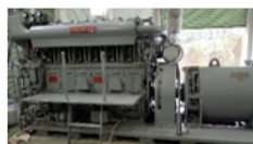
自家発電設備更新
