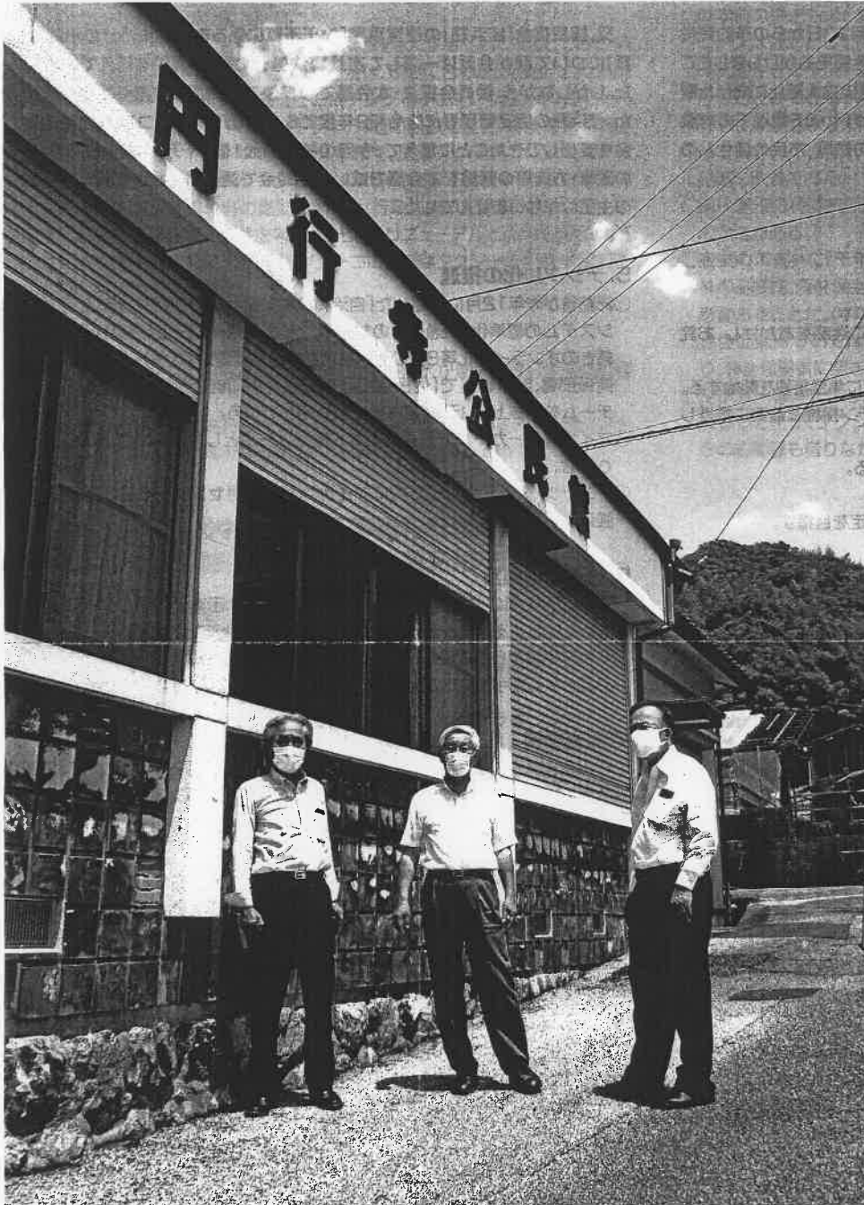
地域コミュニティの拠点となる集会所は修繕が必要な施設が多くなってきています
