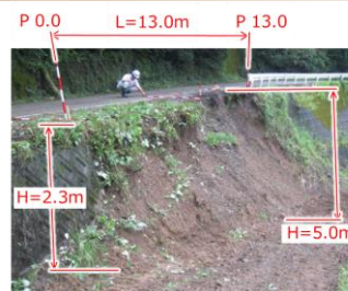
土佐山4号線 路側欠損
