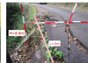
土佐山197号線 路側欠損
