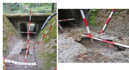
鏡柿ノ又 水路底板欠損 L=3.5m W=1m H=0.3m
