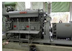
自家発電設備更新
