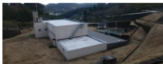
中継ポンプ施設全景
