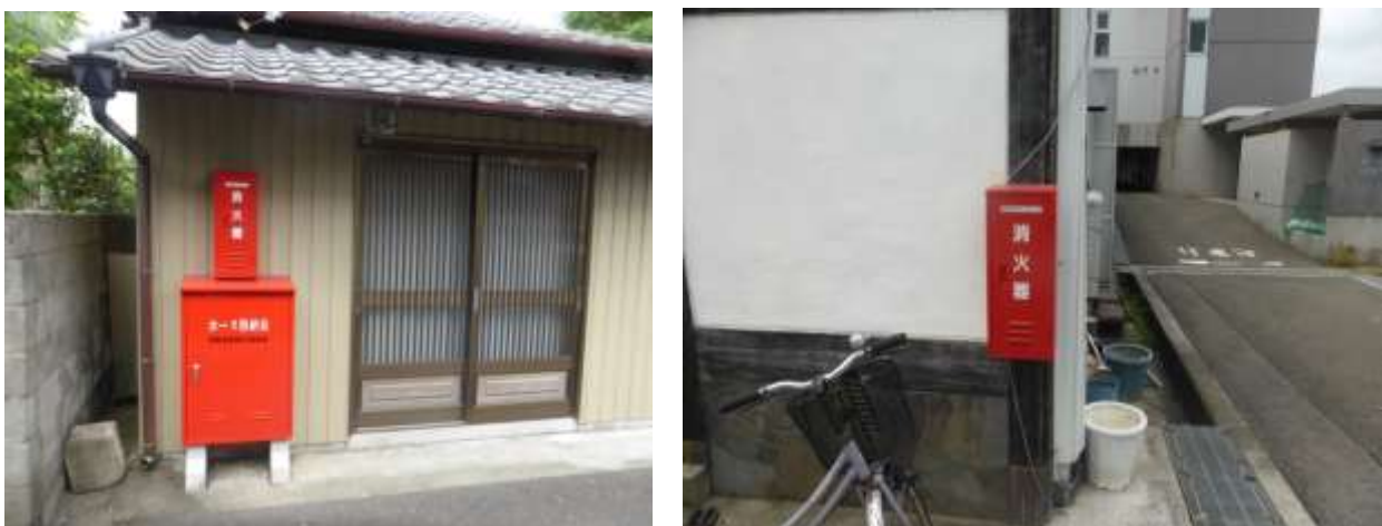
図 2-9 重点推進地区（旭小学校区）内の消火器等の設置 例
