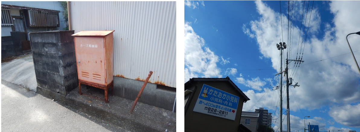
<前里地区内の消防水利・防災資機材>
