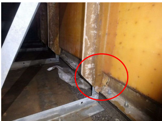
ピット内状況 補強リブ下部破断 (多数あり)
