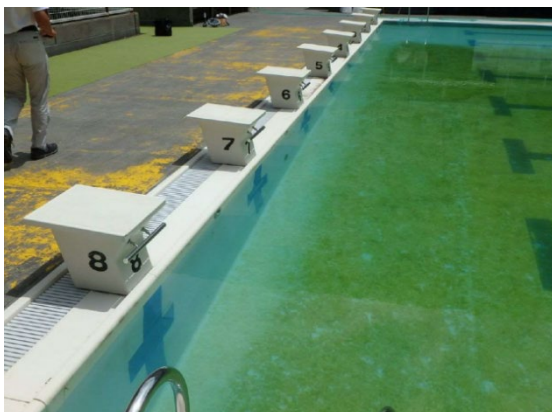
「短辺壁」にたわみが発生
