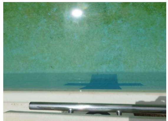
「短辺壁」にたわみが発生
