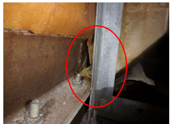
ピット内状況 補強リブ下部破断 (多数あり)
