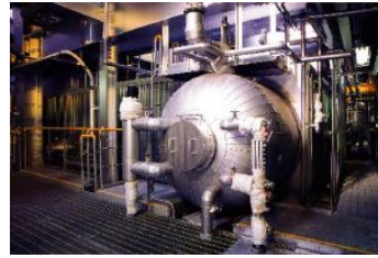
●蒸気を取り込み発電に繋げる清掃工場のボイラ施設
