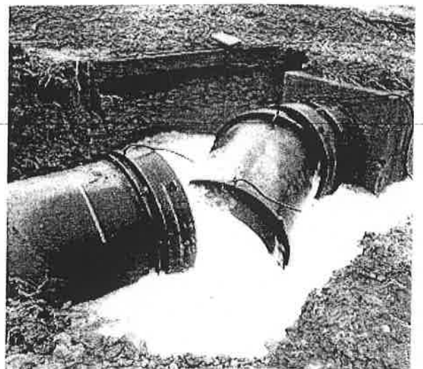
強い揺れで耐震継ぎ手が離脱した、 直径2メートル強の巨大送水管
