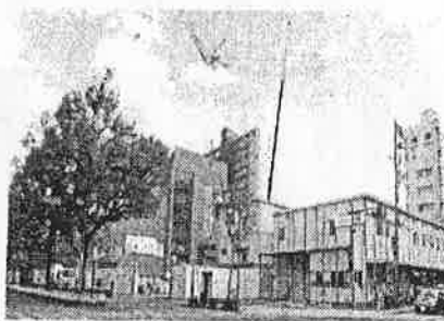
クレーンが林立する建設中の新図書館 右手前は(仮設)市民図書館
