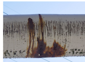
水道管の腐食(錆汁)
