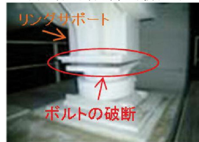
(d) 上沓とリングサポート下端でのボルト破断 (P-4)
