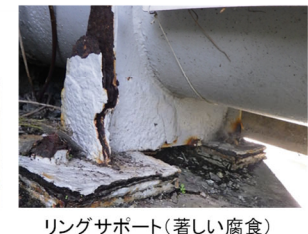
リングサポート(著しい腐食)
