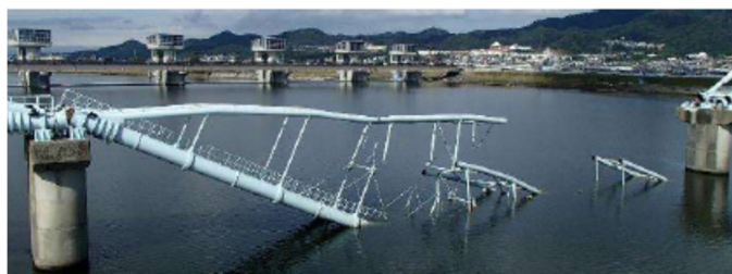
（落橋状況 全景）
