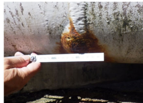
現地溶接部の腐食(錆こぶ)
