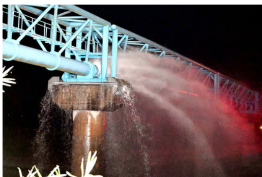
（漏水状況 全景）
