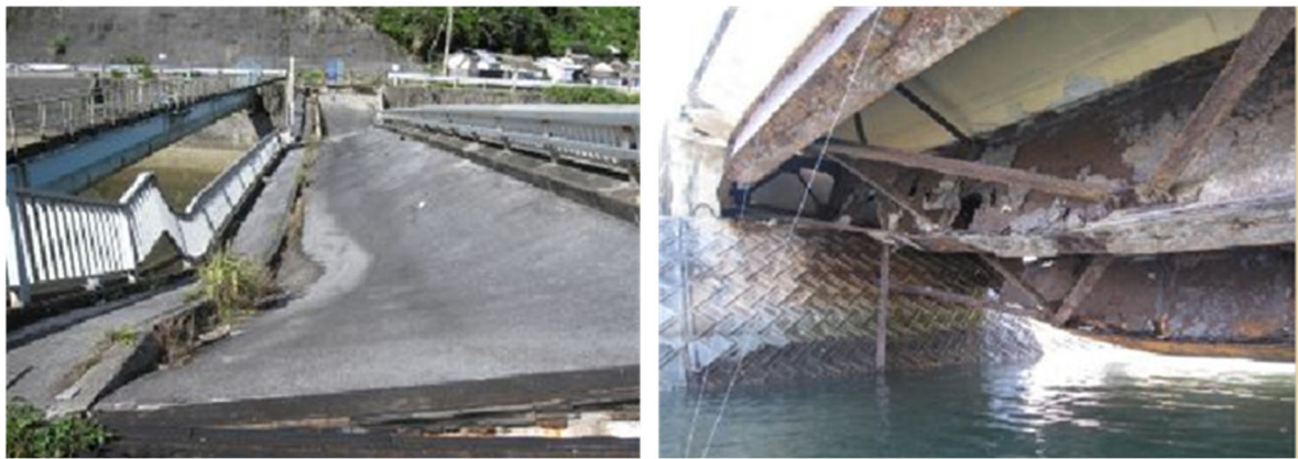
（辺野喜橋 崩落状況）
