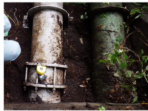
伸縮管の異常(変位発生)
