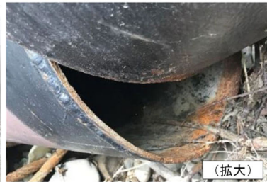
【下弦材(破断部)】
