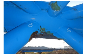
上弦材(部材接合部)の腐食
