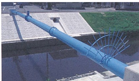
ダクタイル鋳鉄管の事例
