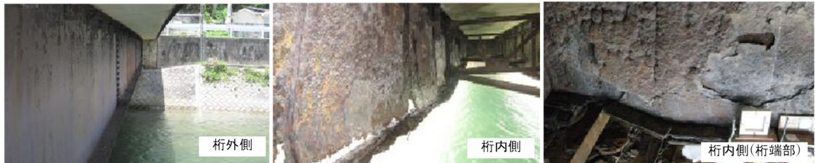
（鋼桁腐食状況）
