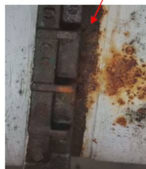
腐食している箇所
