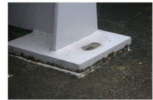
リングサポート(アンカーボルト消失)
