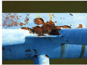
下弦材(部材接合部)の腐食
