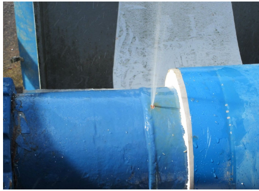
〔ピンホールからの漏水〕
