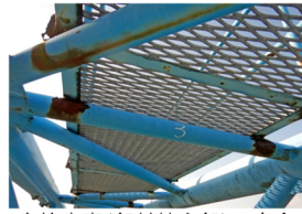
点検歩廊(部材接合部)の腐食
