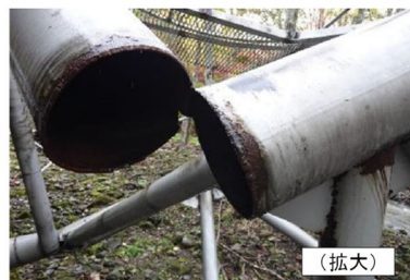
【上弦材(破断部)】
