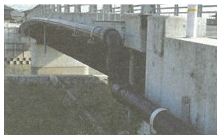
ポリエチレン管の事例
